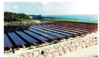
メガソーラーシステム(宮古島)
